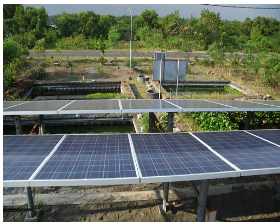
Pembangkit listrik Tenaga Surya (PLTS)
